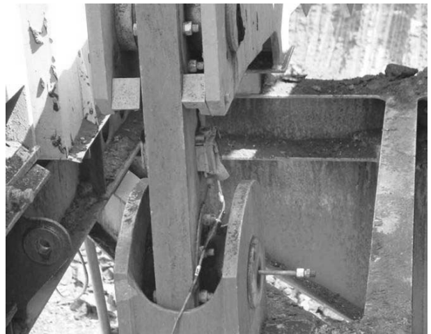
Rys. 5. Lokalizacja czujnika tensometrycznego na łączniku dźwigni momentowej
